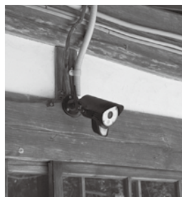
個人宅に設置されている防犯カメラ
