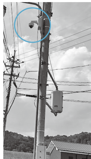
防犯カメラの設置状況（甲奴町）
