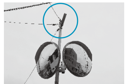
点灯しなくなった防犯灯
