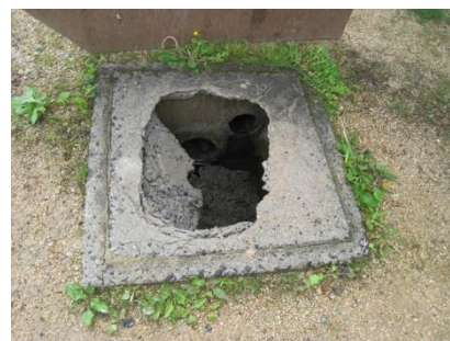
ますふた (柵蓋の破損)
