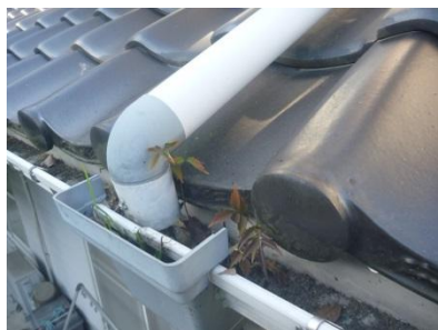
（雨樋のつまり）
