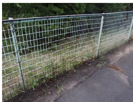
（フェンスに発生したサビ）
