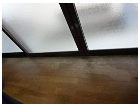
(結露による床損傷)
