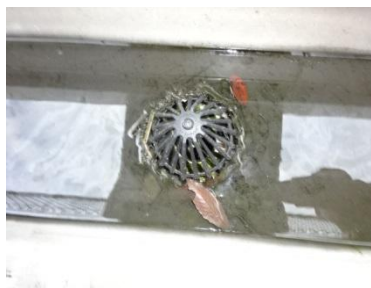
（屋上排水口に溜まった水）
