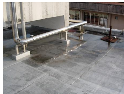
（受水槽の漏水）
