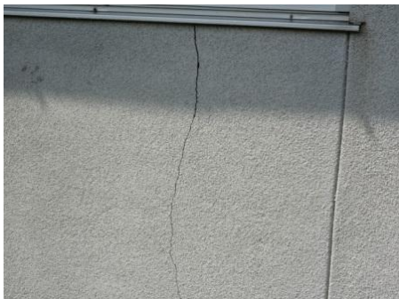
(外壁のひび割れ)
