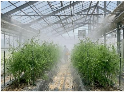
(細霧冷房システム)
