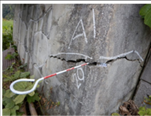
下部工のひび割れ
