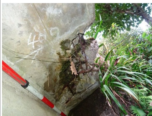
コンクリート床版の鉄筋露出
