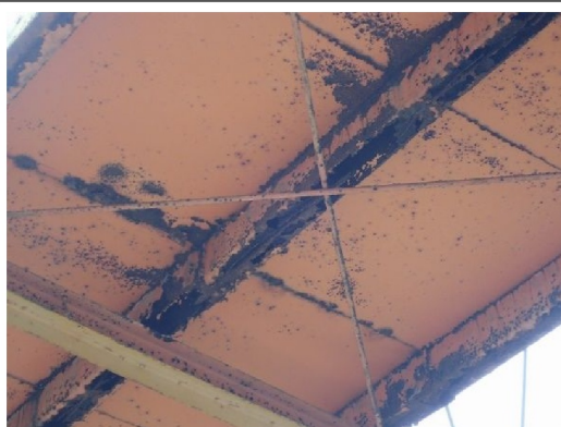
主桁の腐食・防食機能の劣化
