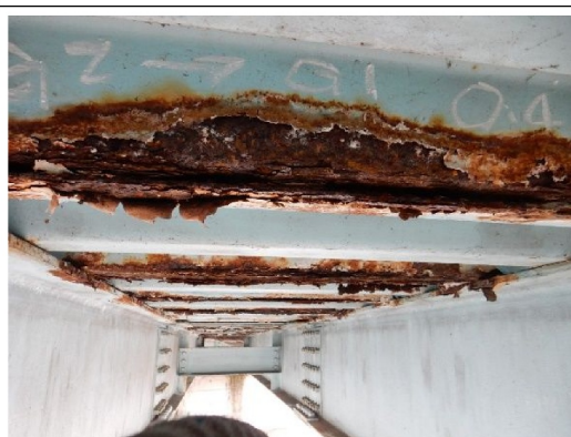
鋼床版の腐食・欠損
