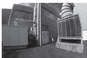
(吸収式冷温水機、冷却塔)
