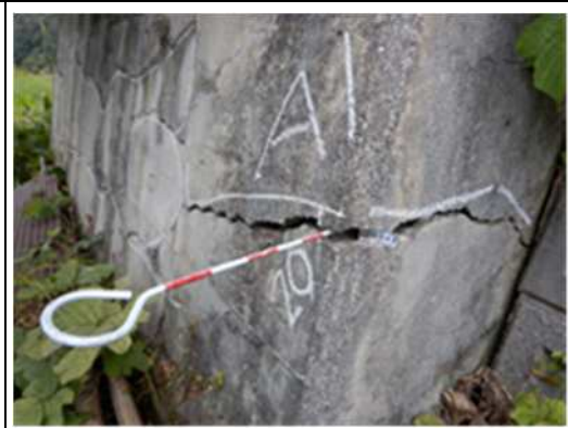
下部工のひび割れ
