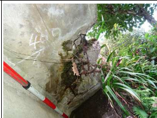
コンクリート床版の鉄筋露出
