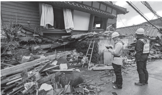
被災した家屋の被害判定調査の様子
