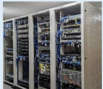
ケーブルテレビ設備
