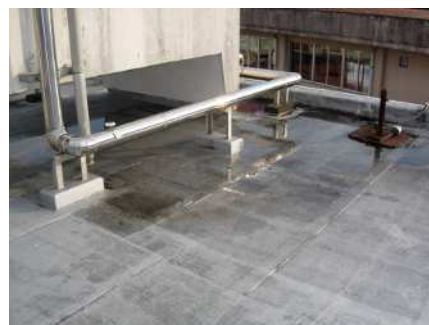
（受水槽の漏水）
