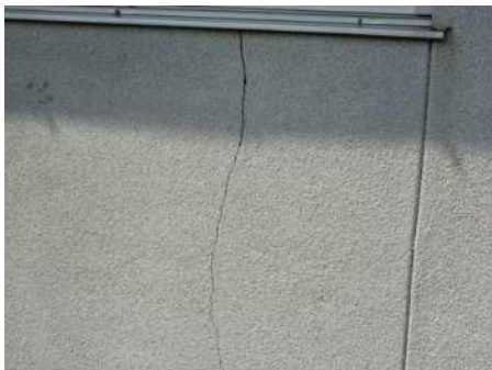
(外壁のひび割れ)
