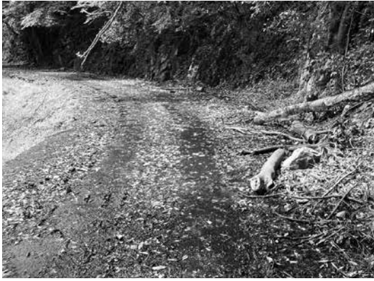
水路側溝が機能していない状況
