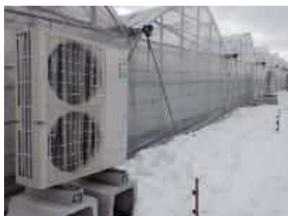
ヒートポンプ (産地生産基盤パワーアップ事業)
