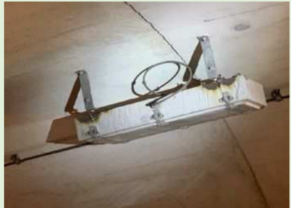
照明 (錆びが発生し, 落下の危険性がある)
