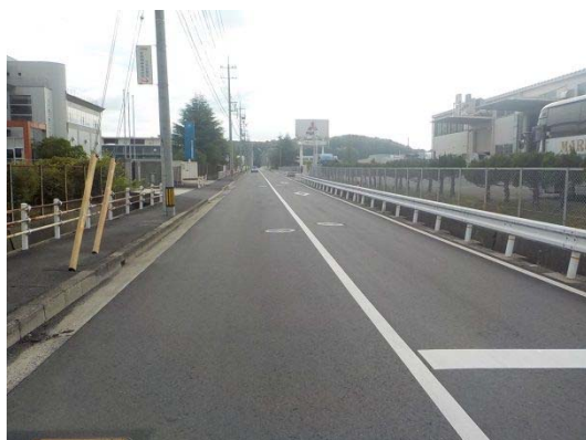
アスファルト舗装の改築工事 (市道中畦七日市線 三次工業団地内)
