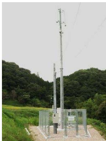
布野町横谷地区携帯電話基地局
