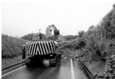
後山町災害現場(平成26年8月)
