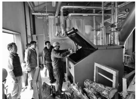
北広島町芸北の温泉施設の薪ボイラー
