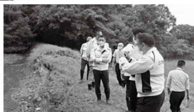
大雨の被害を受けたため池を確認
