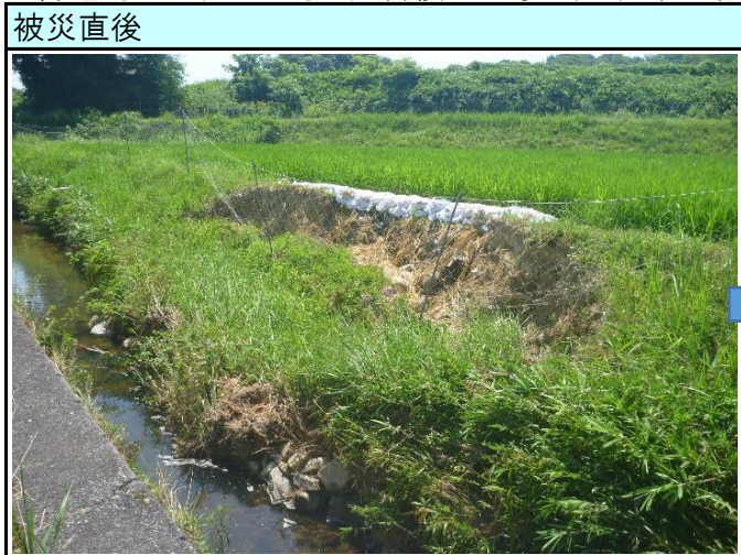
普通河川大仙川 河川災害復旧工事（三次市三和町羽出庭）
