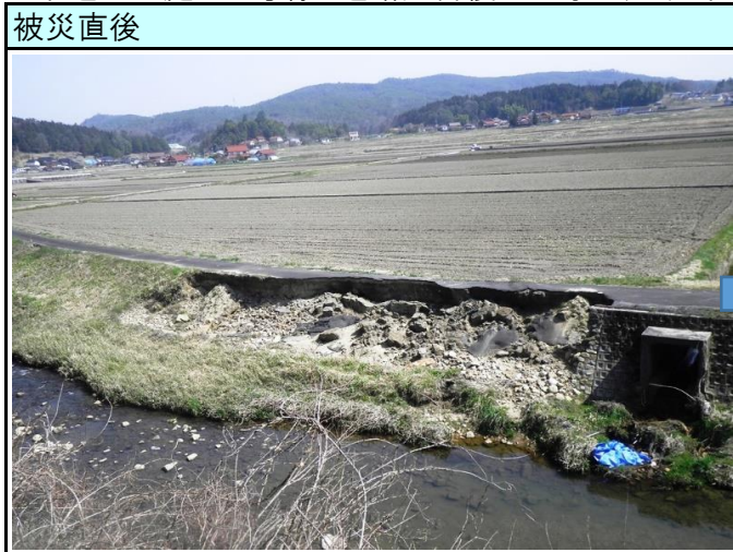
市道羽出庭123号線 道路災害復旧工事（三次市三和町羽出庭）
