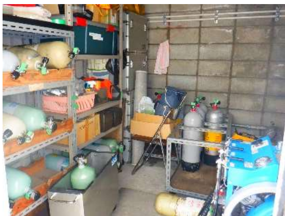
ボンベ保管庫
