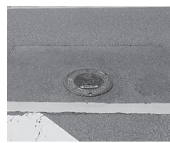
上水道バルブボックス蓋
